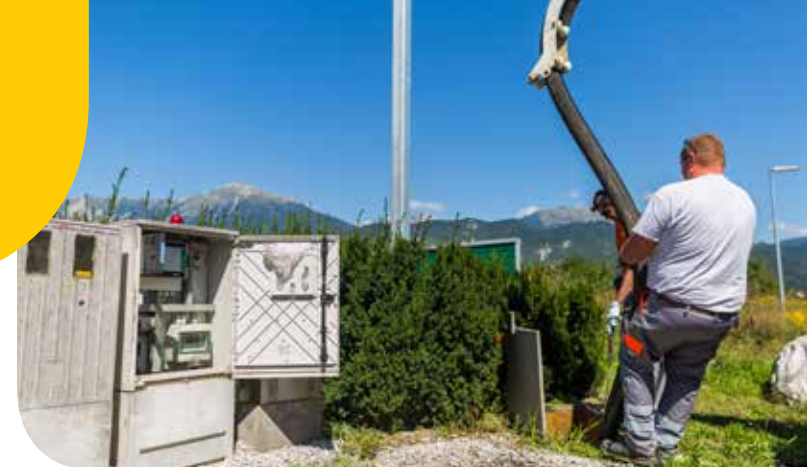
Vseh šest črpališč v občini je opremljenih z daljinskim nadzorom.
